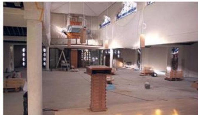
Noch eine große Baustelle: Blick in das nun hellere Innere der Pfarrkirche.
